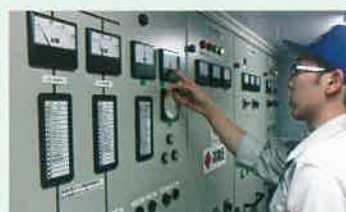
発電機並列運転
